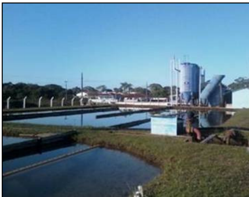
Figura 27 – Vista da ETA Principal
