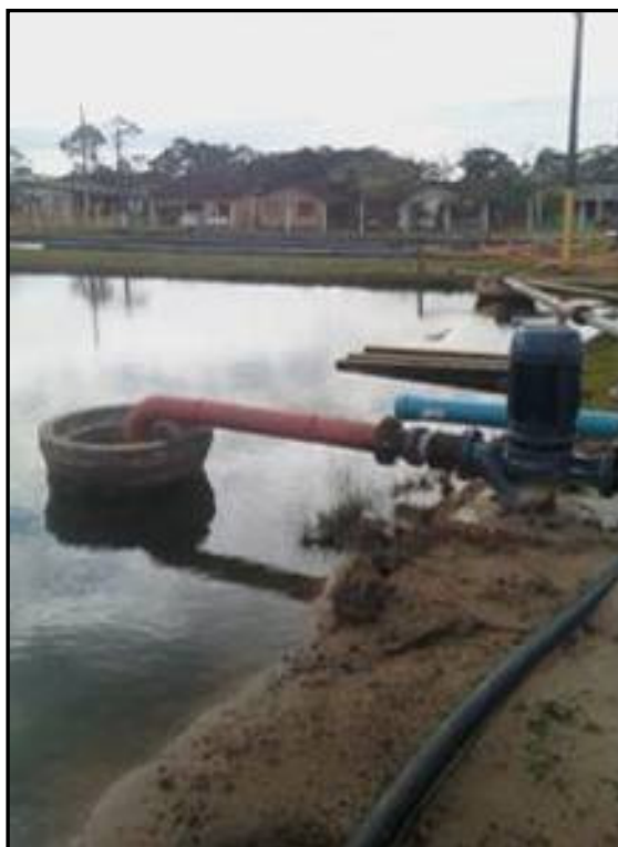
Figura 33 – Detalhe da Captação da Água Clarificada na Lagoa de Decantação 3
