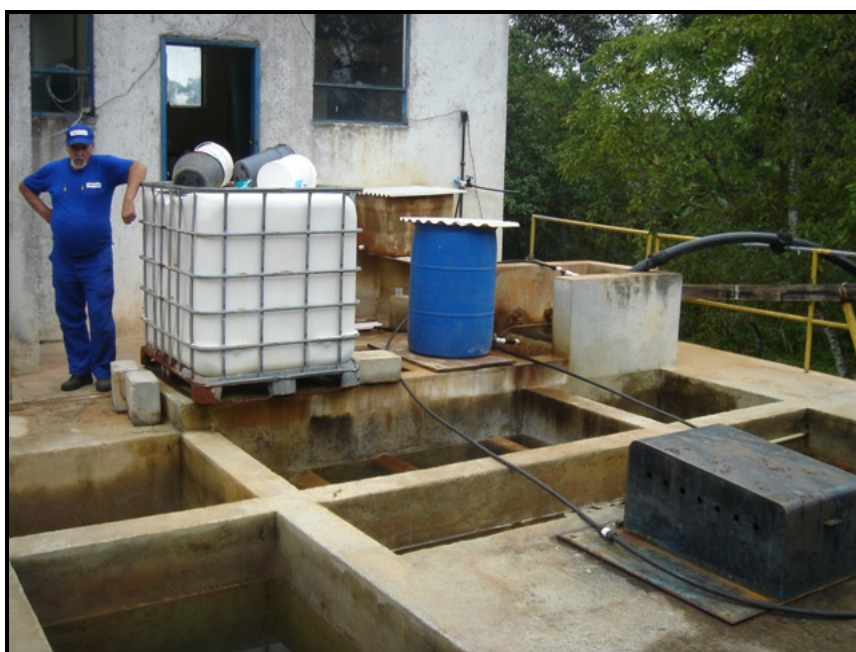
Figura 45 – Vista do Filtro
