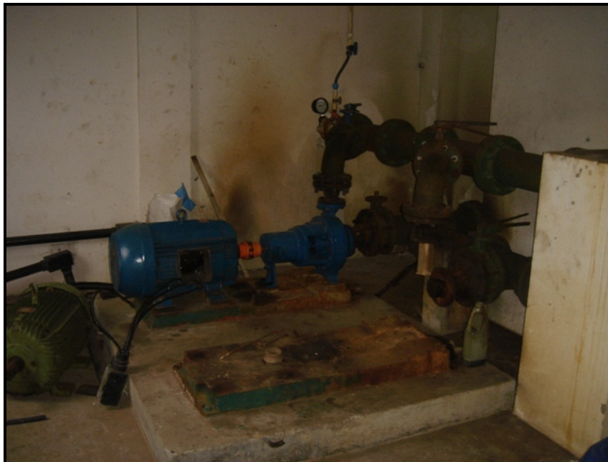
Figura 26 – Bomba de Recalque de Água Tratada
