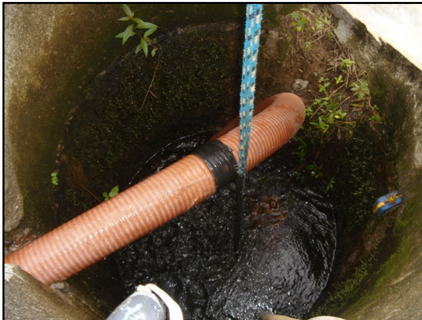
Figura 22 – Poço de Sucção de Água Bruta – ETA Secundária
