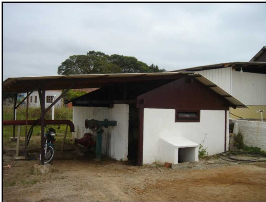
Figura 48 – Vista do Tanque de Contato de Água Tratada
