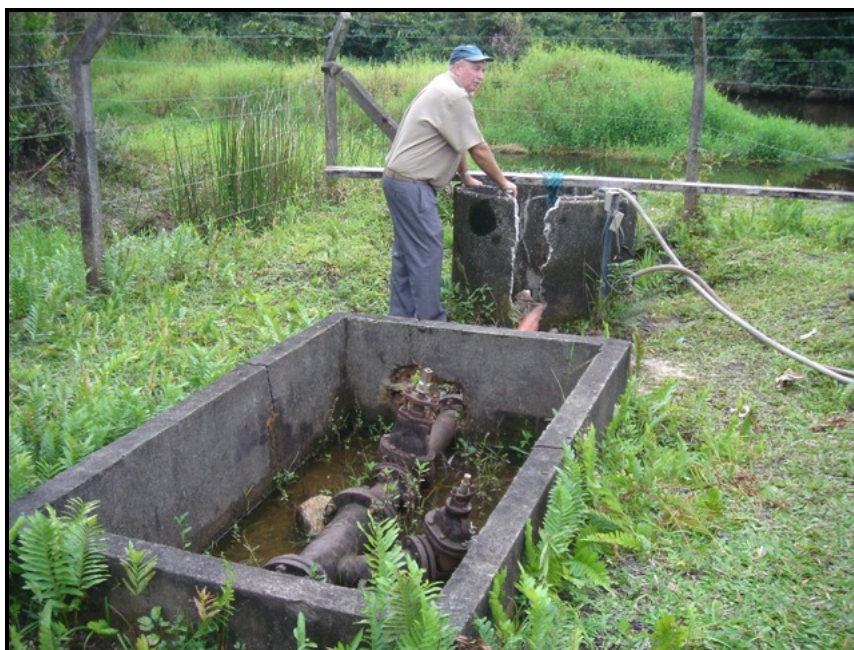
Figura 23 – Captação de Água - ETA Secundária – Rio Sai Mirim
