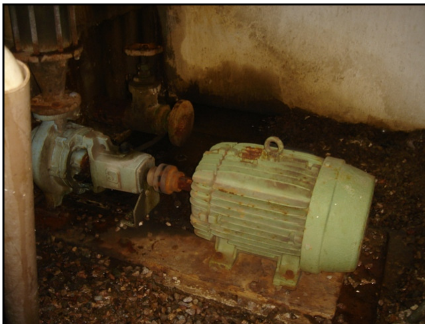
Figura 25 – Bomba de Recalque de Água Tratada
