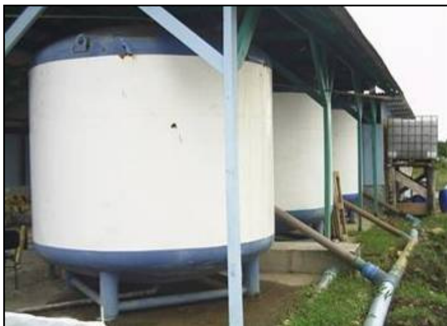
Figura 34 – Vista dos Filtros Russo
