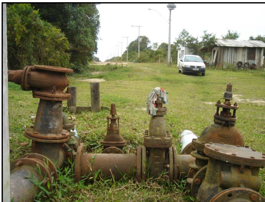
Figura 24 - Adutoras da ETA Principal – 2 de DN 200 em Ferro fundido
