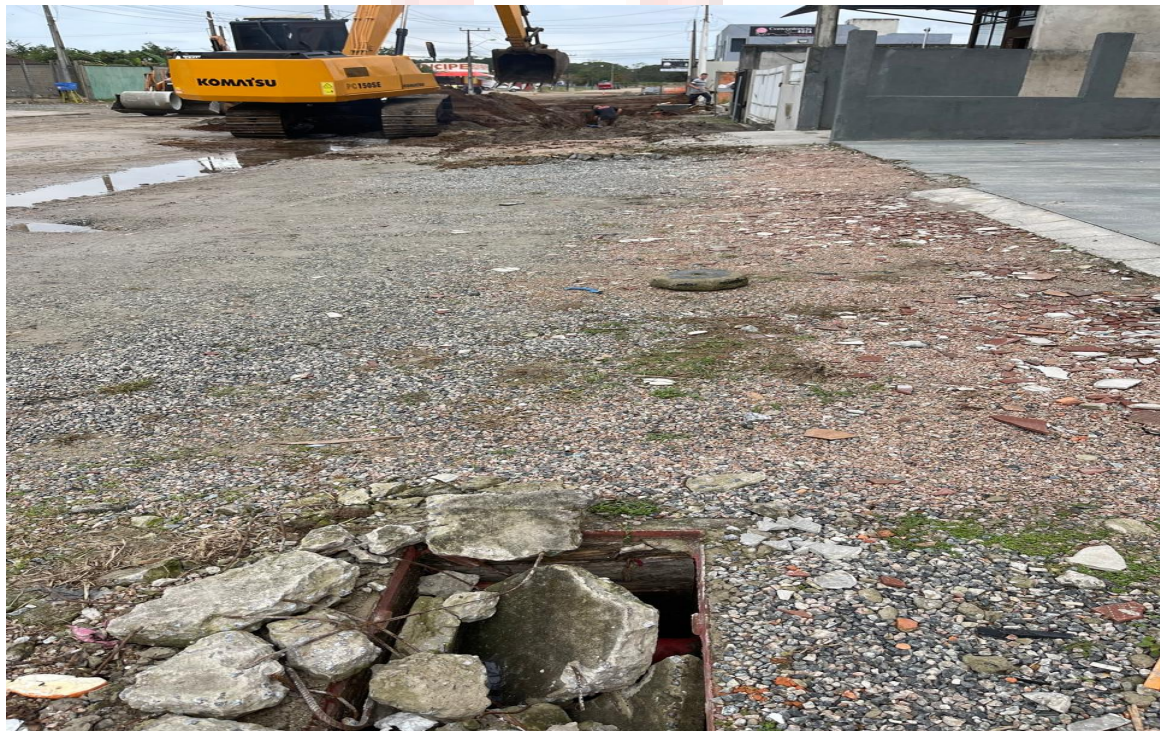
fig. 4 - Rede de hidrante do prédio residencial nº 3014 da Av. Celso Ramos.
