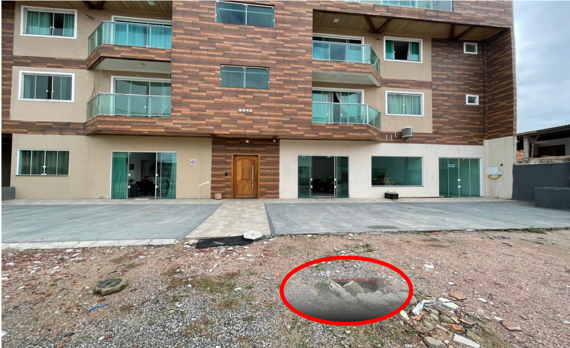
fig. 5 – detalhe da entrada de hidrante do prédio residencial nº 3014 da Av. Celso Ramos.
