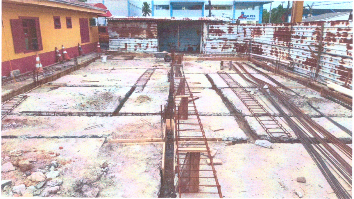
Figura 2- Falta de Formas para Vigas Baldrane
