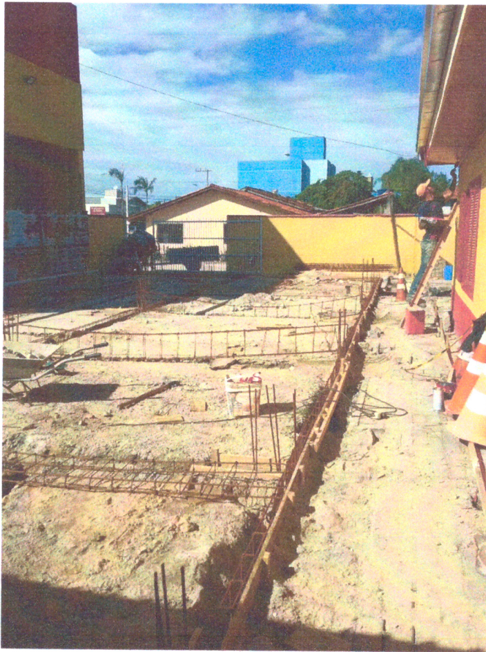
Figura 3 - Falhas armaduras vigas baldrame
