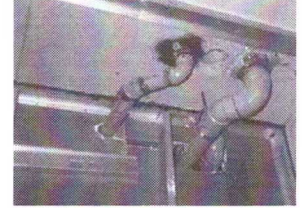
Tubagens de escoamento de água
